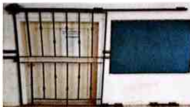
Figura 10. Puerta corrediza con sistema de riel.
