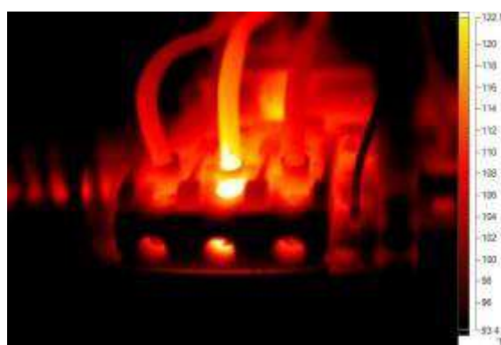
Figura 1: Puntos calientes en tableros eléctricos Fuente: FLUKE, 2020
