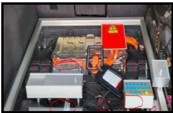
Figura 5. Batería de alta tensión del vehículo AUDI Q5.
