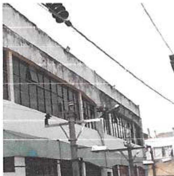
Imagen 1 Estructuras Trifásicas del Patio de Maniobras
