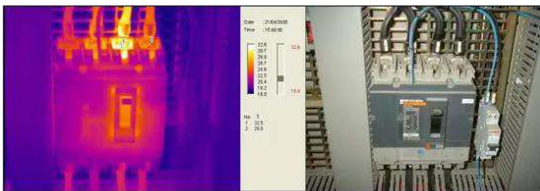
Figura 2: Incremento de resistividad debido a que los conectores no ajustan bien. Fuente: INDUNOVA, 2016
