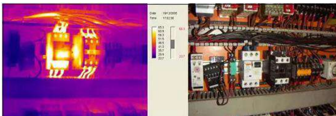
Figura 3: Imagen termográfica de dispositivos de protección sobrecargados. Fuente: INDUNOVA, 2016
