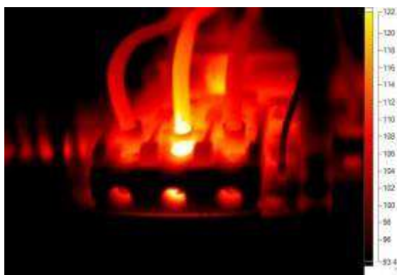
Figura 1: Puntos calientes en tableros eléctricos Fuente: FLUKE, 2020
